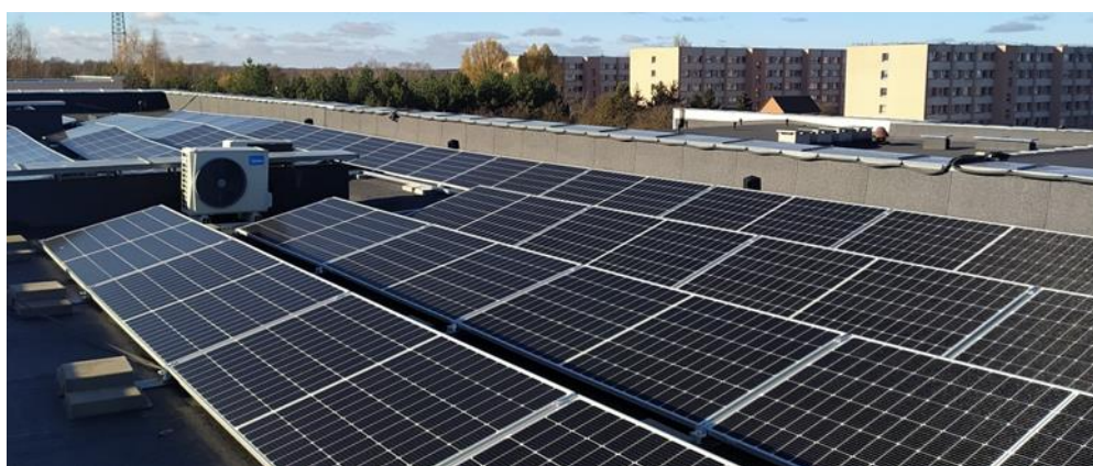
Saulės elektrinė Juozo Tumo -Vaižganto gimnazijoje
